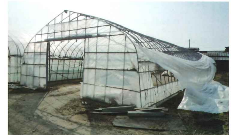
▲強風により被覆材に被害を受けたハウス
