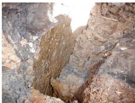
疎水材「もみ殻」の腐食による空洞化(空洞化部分に土壌が落下している。)
