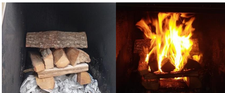
図7 ウッドボイラーの薪焚き室(左：薪設置時、右：燃焼時)
